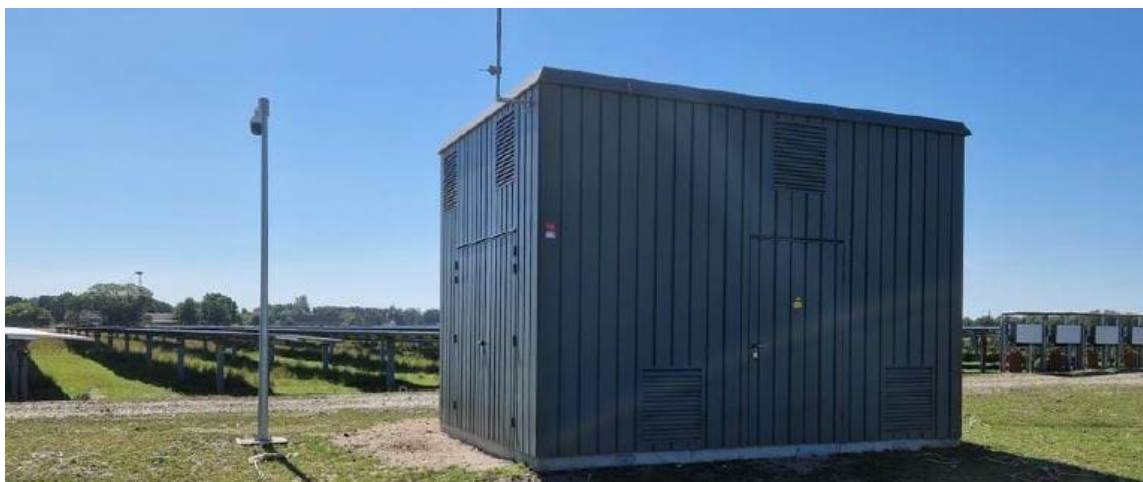
Billedet viser et eksempel på en transformerstation. I baggrunden ses solceller med trackersystem.
