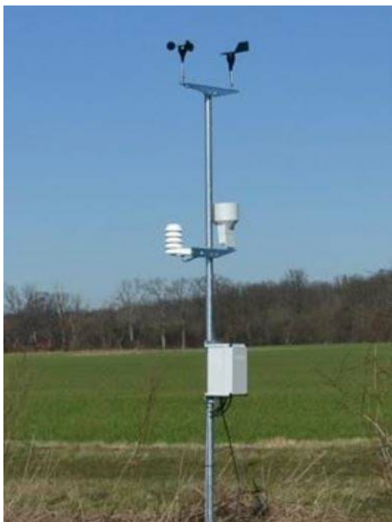
Billedet viser et eksempel på en vejrstation.
