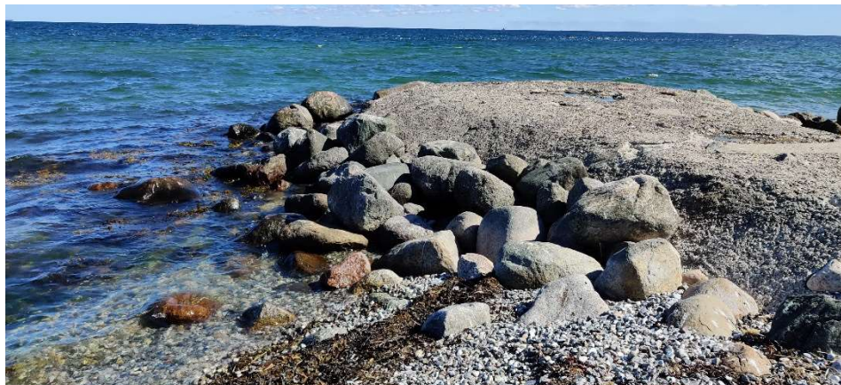
Figur 4.64: Foto af betonhøfde med omkringliggende sten. Stenene ligger spredt, hvilket indikerer at stenbeskyttelsen ikke er stabil og at de under en storm vil kunne blive flyttet rundt.
