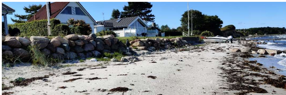
Figur 4.38: Skråningen er beskyttet med en stenkastning eller en mur opbygget af sten eller beton. Flere steder er skråningen dækket af vegetation i form af græs eller rynket rose.
