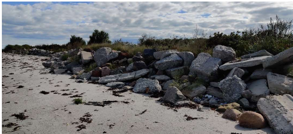
Figur 4.34: Foto af stenkastning mellem st. 942-950. Stenene/betonen ligger ikke stabilt og har ikke tilstrækkeligt filterlag.
