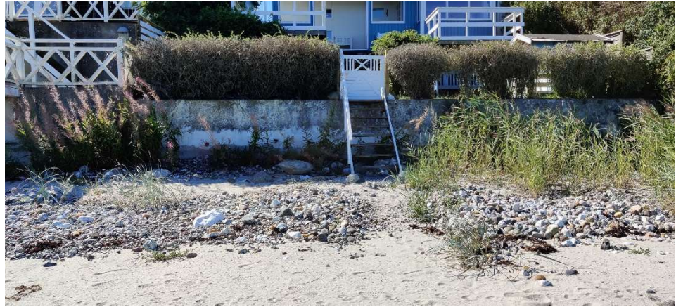
Figur 3.3: Eksempel på betonmur. Terrænet foran og bagved muren er i forskellig højde. Fotoet er taget under kystinspektionen d 1/9-2020.
